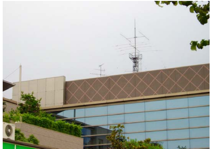
写真2. さやかホールの屋上に設置されたアンテナ群
